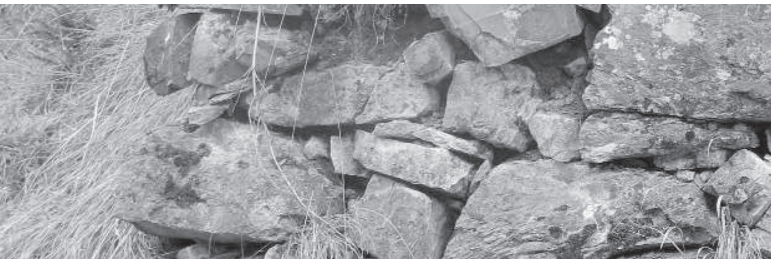
herausgefallene und verschobene Steine
