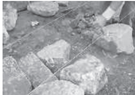
Bearbeiten und Setzen der Fundamentsteine, darüber Schnurgerüst für den weiteren Maueraufbau, Internationales Sanierungsprojekt Vanovagasse, 2015, Bludesch und Thüringen
