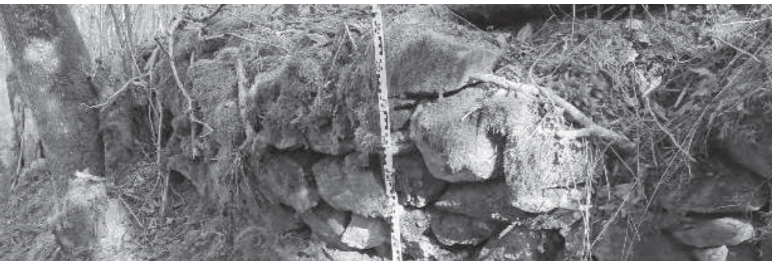
überhängende Mauer mit Ausbauchungen, herausgefallenen Steinen und verschobenem Verband
