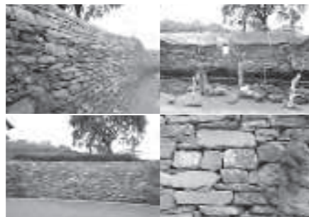
Best-Practice-Beispiel fachgerechten Trockenmauerbaus: Sanierung straßenbegleitender Stützmauer Achrain Dornbirn, 2016, durch die Abteilung Straßenbau (VIIb)
