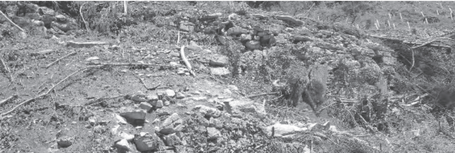
beinahe vollständig verfallene Mauerbereiche
