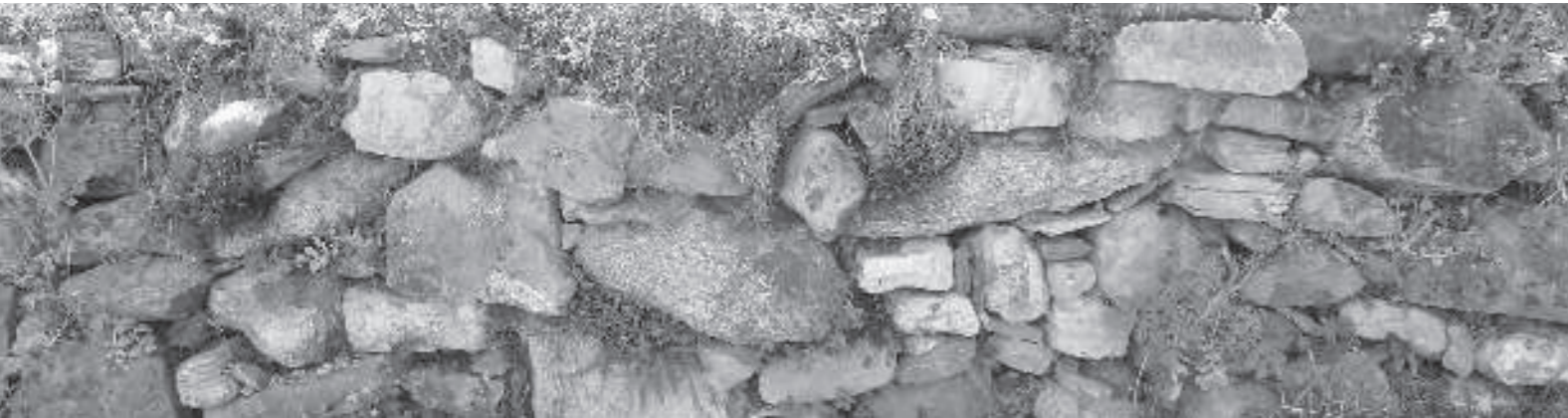
nicht fachgerecht ausgeführte Baumaßnahmen
