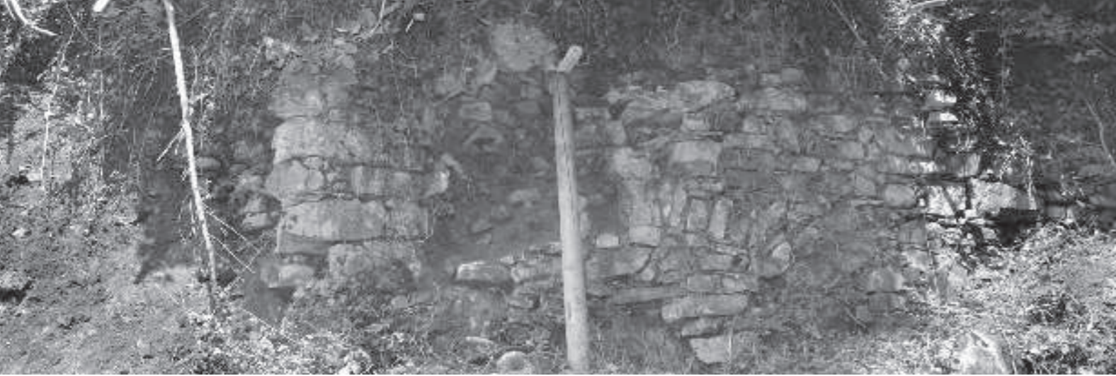
Ausbrüche in einer Mauer
