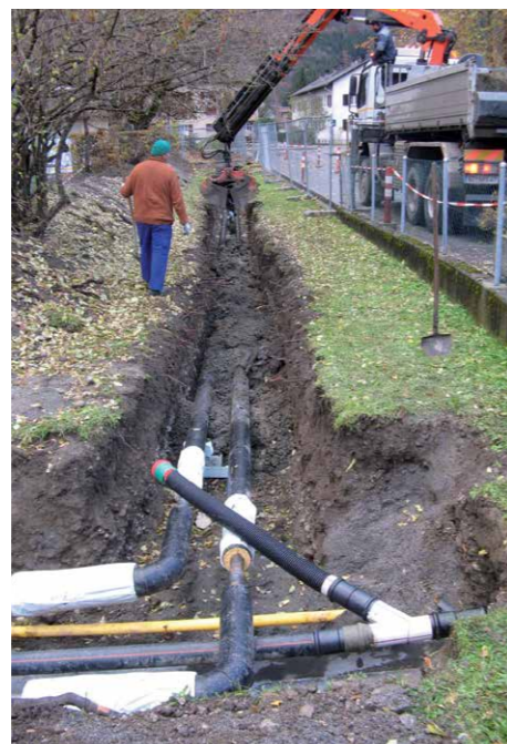
Über eine rund 900 Meter lange Leitungstrasse werden die externen Abnehmer mit Fernwärme versorgt.
