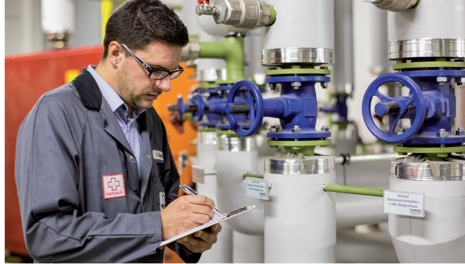
Durch das Zusammenspiel von Wärmeerzeuger und –abnehmer mit Zortström® Technologie ist der Spitzenlastkessel nur noch 6-8 Monate p.a. in Betrieb.
